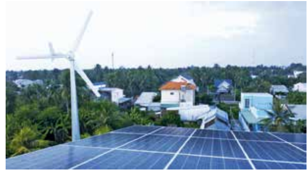
Abb. 3: PV-Anlage und Kleinwindturbine (Foto: Tanvu Luong)
