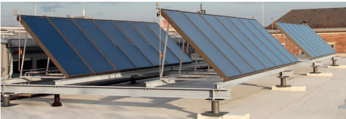
Abb. 2: Flachkollektorfeld auf dem Dach des Gebäudes K
